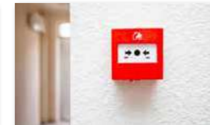
Détection / Protection incendies
